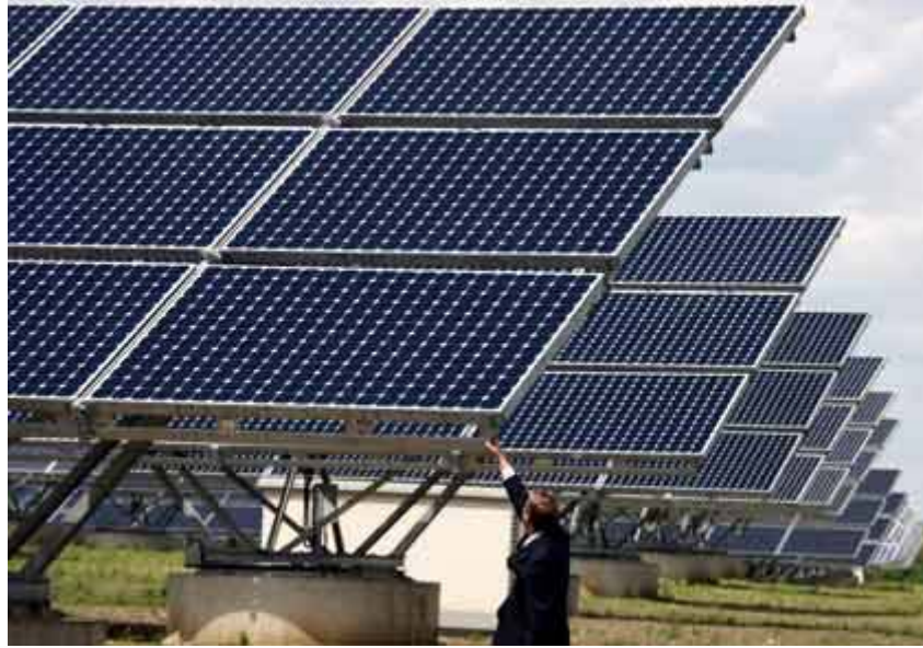
Centrale fotovoltaica sulla Terra: dipendente dal tempo e dall'ora.
