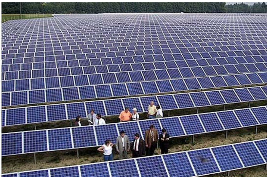
Impianto fotovoltaico della First Solar
