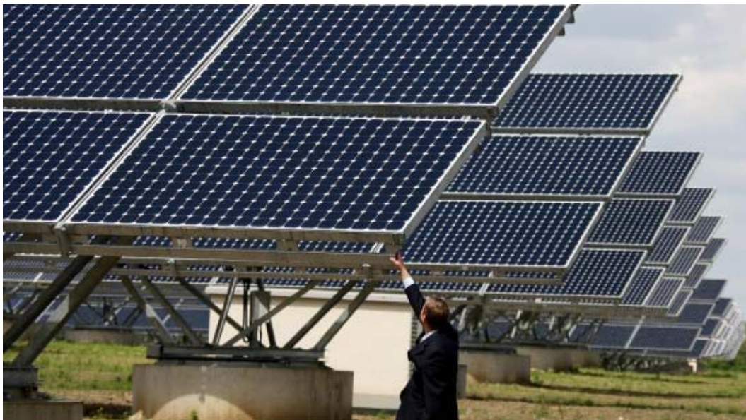
Un impianto fotovoltaico in Germania: la produzione elettrica più costosa
