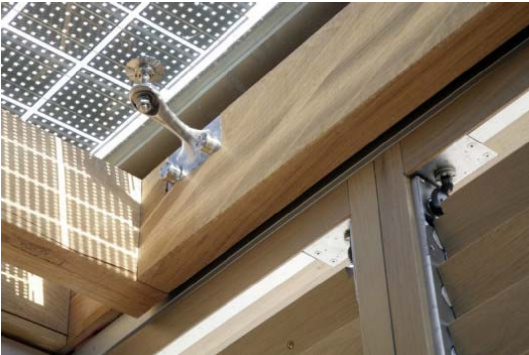
L'impianto FV con celle di silicio monocristallino installato sul tetto
