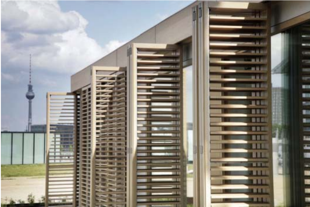
Particolare della facciata con le lamelle regolabili di legno ricoperte con moduli FV a film sottile
