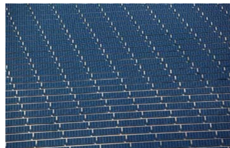
Impianto fotovoltaico in Germania
