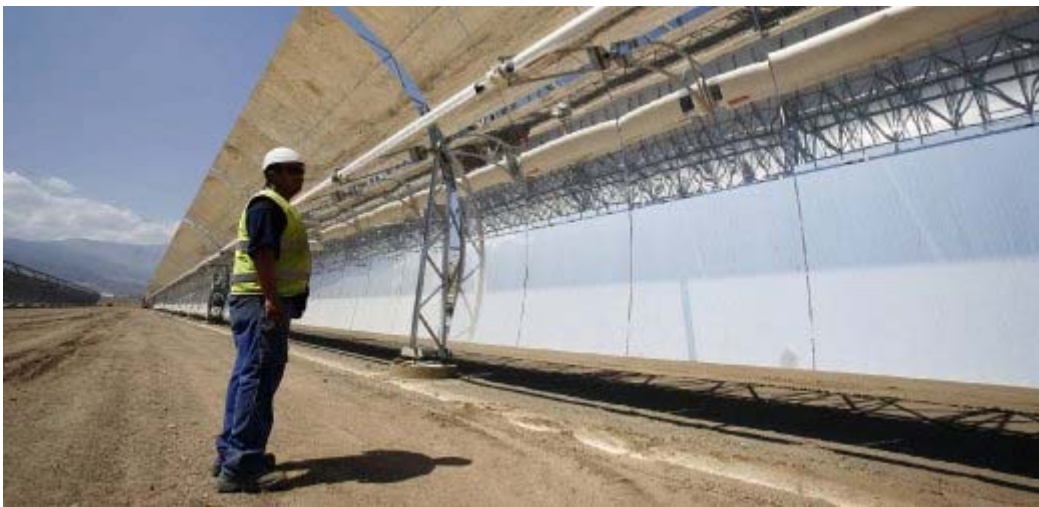
La Solar Millennium costruisce grandi centrali termosolari per esempio in Spagna (vedi immagine)
