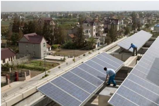
Impianti fotovoltaici a Shanghai.
