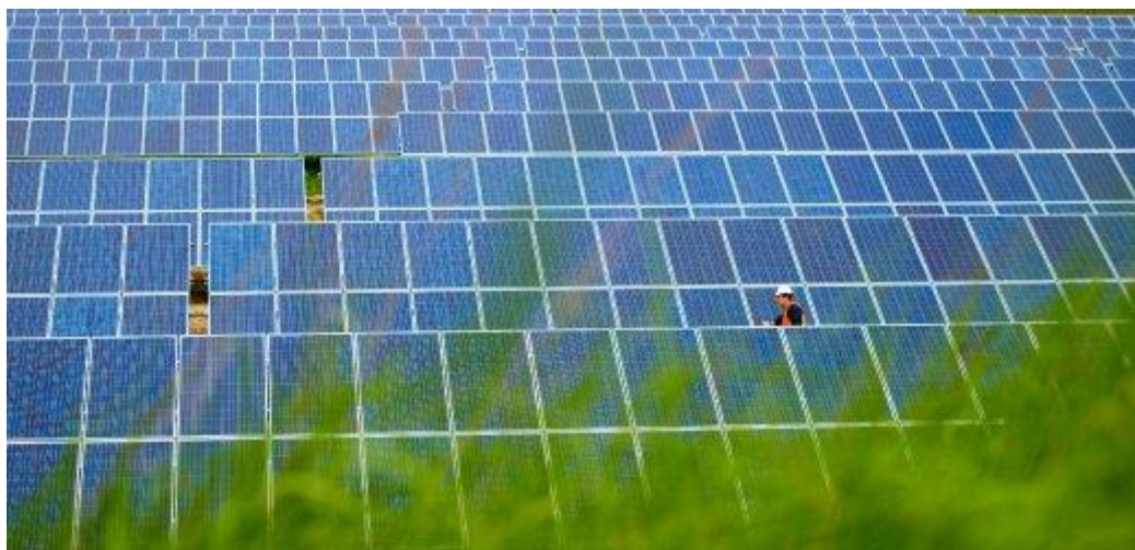
Moduli fotovoltaici di un impianto solare in Germania
