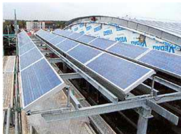
Impianto fotovoltaico sul tetto
