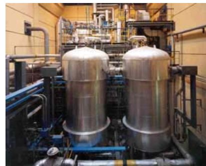
Interno della Centrale
