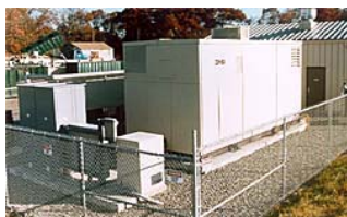
Centrale con celle a combustibile
