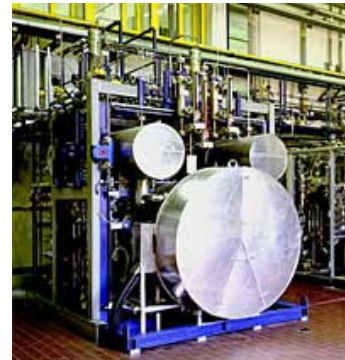
Elettrolizzatore ad alta pressione
