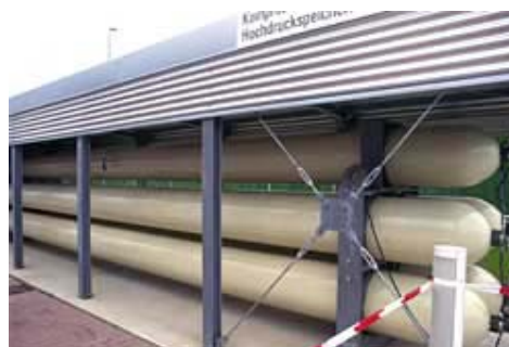
Serbatoi per idrogeno
